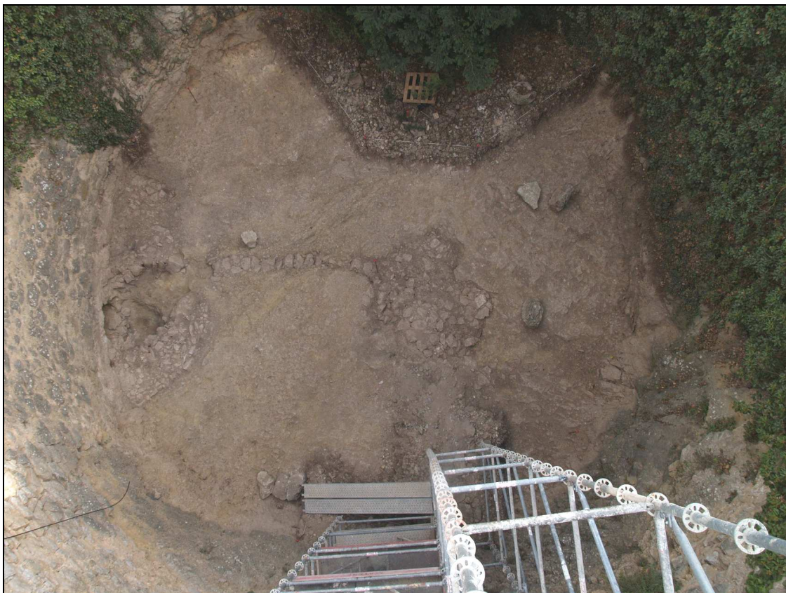
Vista del sistema de desagüe del interior de la cava hacia el final de la intervención.
